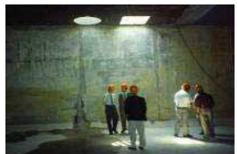
Bassin enterré visitable
